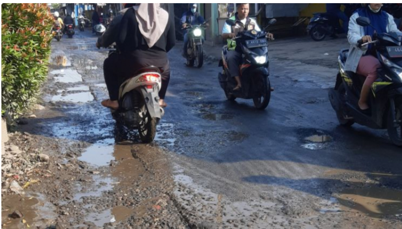
Kondisi Jalan Industri Tarik Kolot ( Dok. Pribadi)
